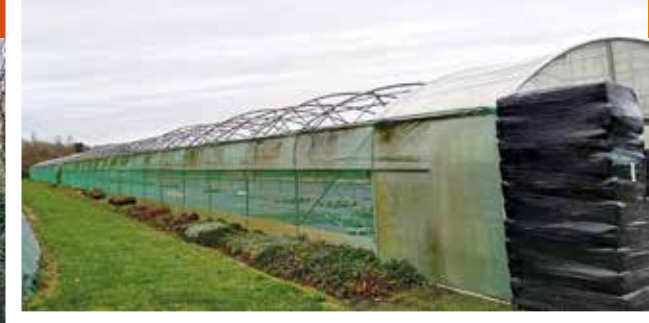
◇ Plusieurs serres et hangars décapités.
